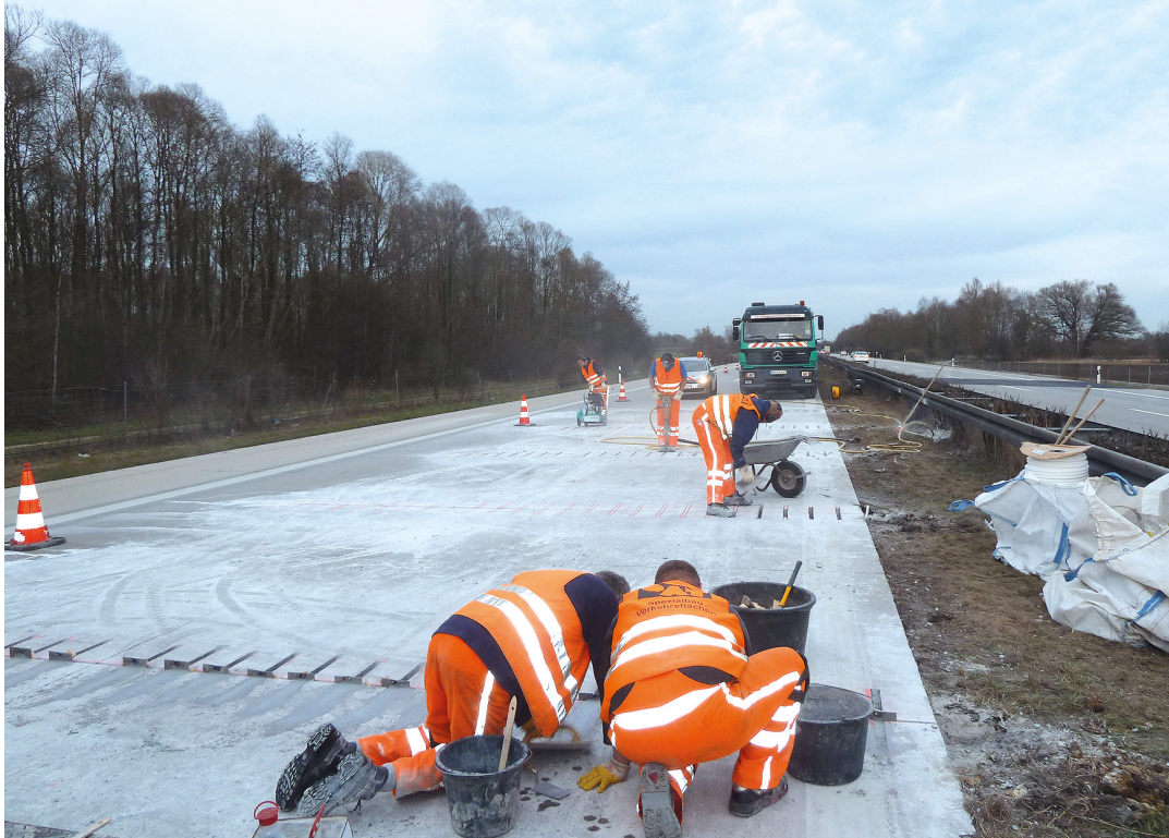
Entspannungsbereiche werden dort geschaffen, wo die Fahrbahn durch Hitzeschäden besonders gefährdet ist. An der A92 wurde ein Entspannungsbereich durch die Anordnung von verdübelten Raumfugen geschaffen. © Autobahndirektion Südbayern
