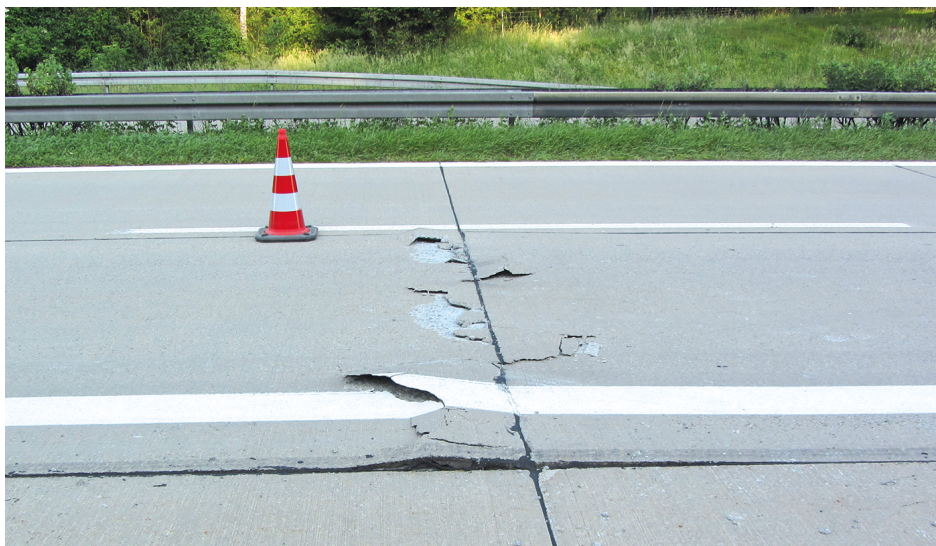
Hohe Temperaturen können zur Abplatzung der Fahrbahnoberfläche führen. © Autobahndirektion Südbayern
